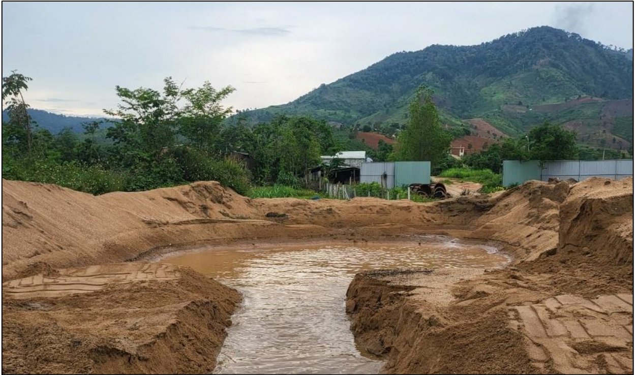
Hình 7. Nước từ quá trình bơm hút cát được thu gom vào hố lắng để lắng bùn đất và rác trước khi trả về sông.
